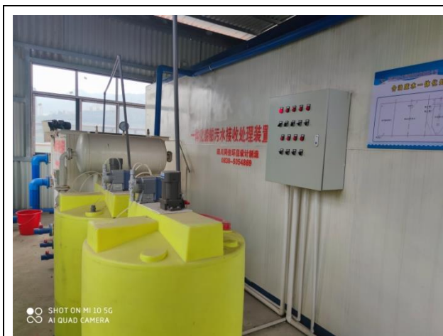
含油废水一体化处理装置
