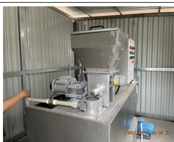
含煤含矿污水处理装置
