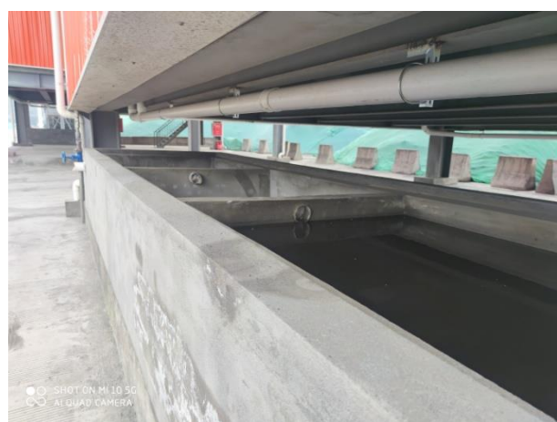
转运站污水收集沉淀池
